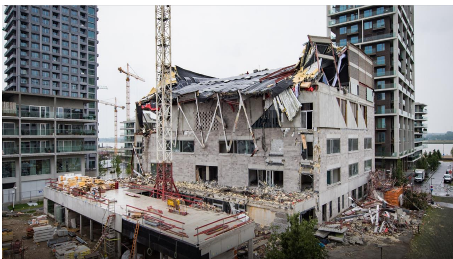
Figuur 19: Het Laatste Nieuws (17 december 2021). Na instorting op Antwerps Nieuw Zuid: onderzoek naar realisatie school en buurtsporthal. ( https://www.hln.be/antwerpen/na-instorting-op-antwerps-nieuw-zuid-onderzoek-naar-realisatie-school-en-buurtsporthal-br~adbb2e1f/204265480/ )
